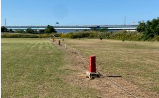
火災予防のため設置の消火栓
