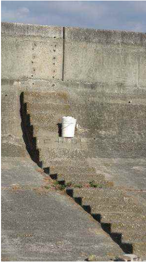
④ 阪神高速11号池田線淀川橋の下流すぐ、ゴミ投棄
