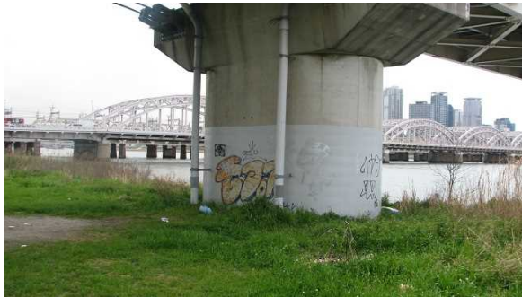
⑭ 十三大橋橋脚 落書き
