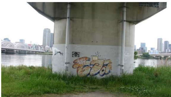
⑭ 十三大橋橋脚 落書き
