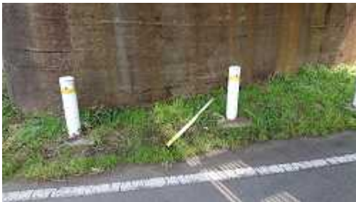
←阪急京都線高架下の設置物の破損
