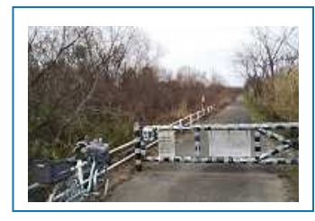
左の工事未施工部
