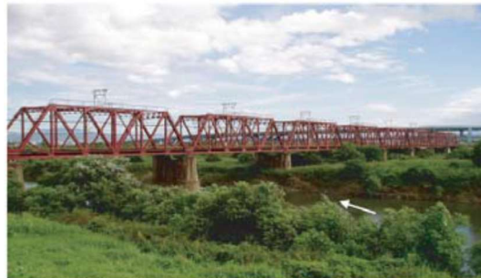
図 2.1 河道内樹木の繁茂状況
