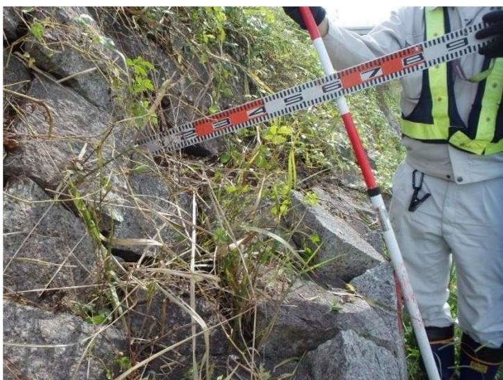
◀ 石積みの 点検状況 (石積みの破損)
