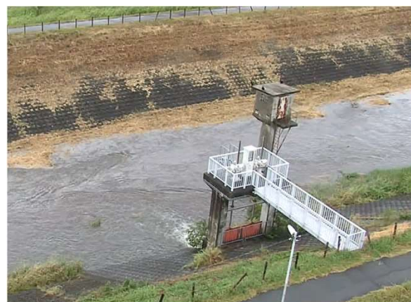
▲ 大島排水機場の排水状況 （令和6年9月出水時）
