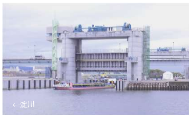
淀川大堰閘門（通船状況）
