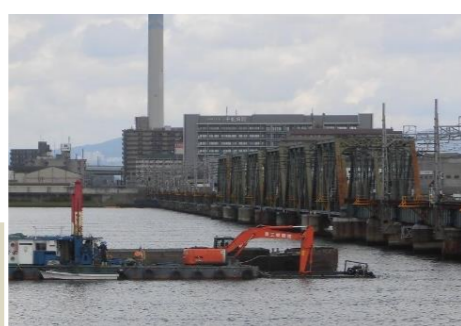
阪神なんば線淀川橋梁架け替え工事における舟運の活用
