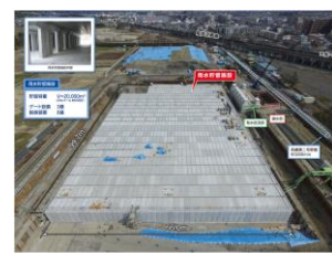
雨水貯留施設(安満遺跡公園)
