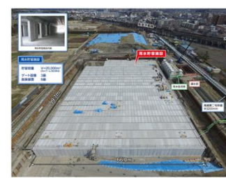
雨水貯留施設(安満遺跡公園)
