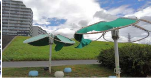
大塚地区:シェルター屋根部分 テント地破損
