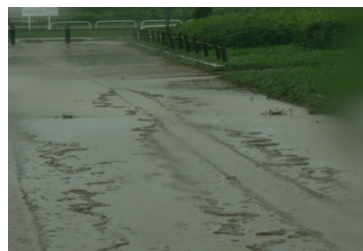
ヘドロの堆積 (大山崎地区)
