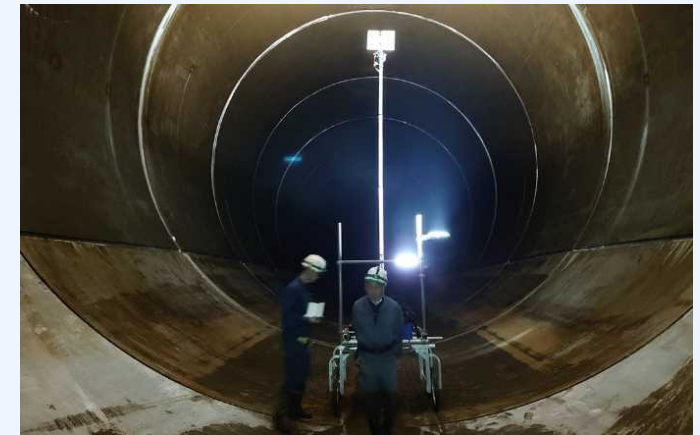
放流後の施設点検
