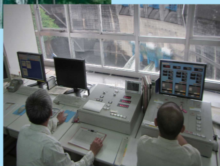
天ヶ瀬ダム操作室
