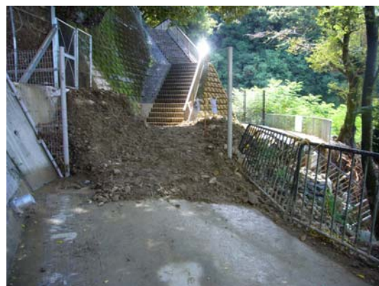
防護柵の流失 (森林公園への道路)
