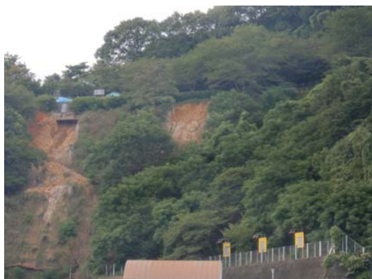
法面の浸食 (森林公園の広場下)
