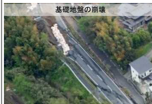
写真-9 国道443号（益城町）
