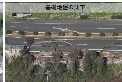
写真-10 九州自動車道（益城町）
