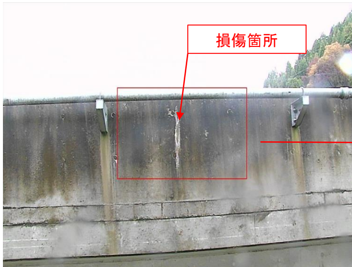
写真-3 損傷確認[ひびわれ]
