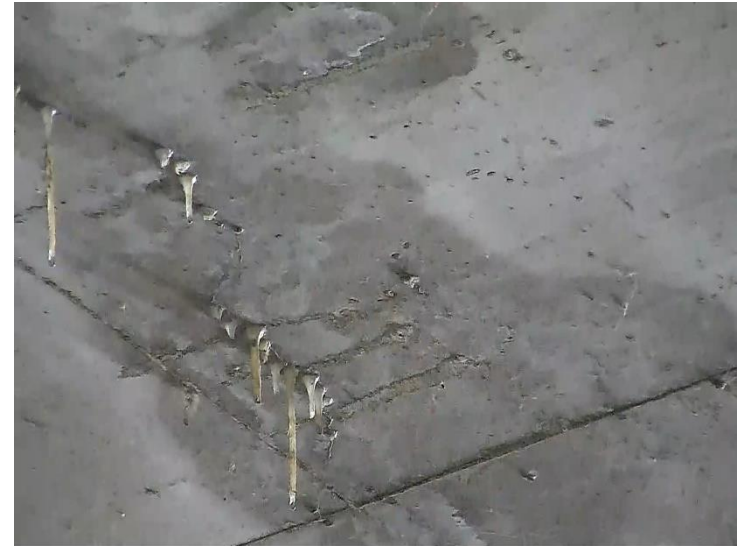
写真-2 損傷写真 (ひびわれ・遊離石灰)
