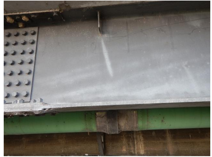
写真-2 損傷写真(防食機能の劣化)
