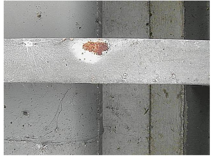
写真-2 損傷写真(腐食)
