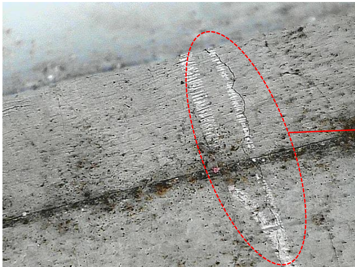
写真-3 損傷写真 (床版ひびわれ)
