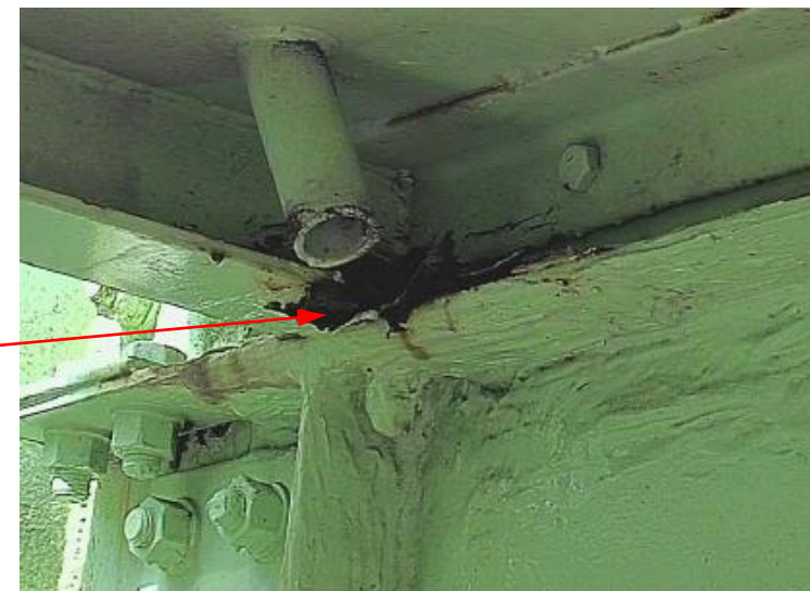
写真-4 主桁(腐食:b、防食機能の劣化:e(分類 I))
