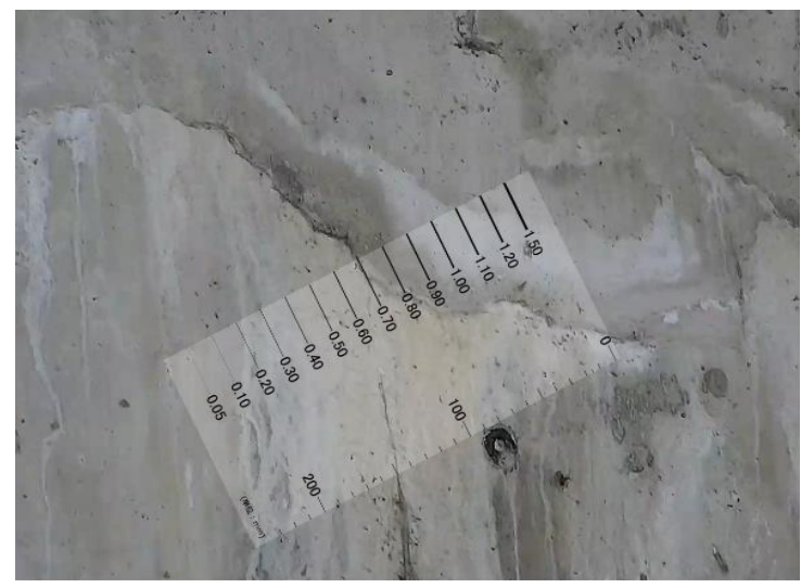
写真-4 ひびわれ幅計測(デジタルスケール)
