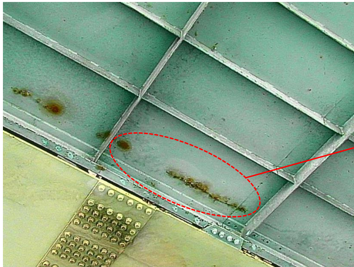
写真-3 損傷写真 (腐食)
