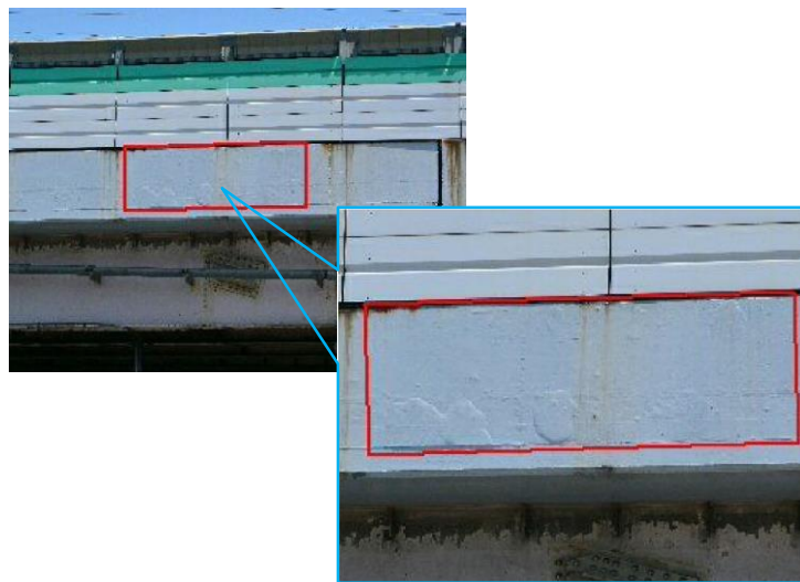
写真-3 損傷確認 (可視画像)
