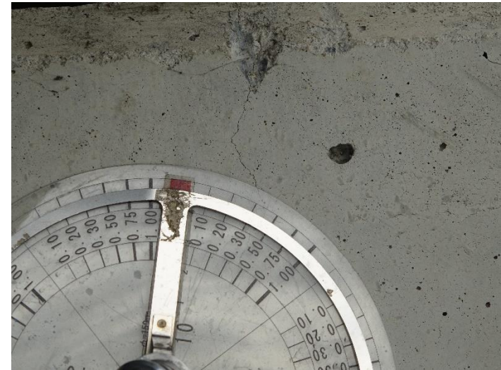
写真-4 損傷確認 (ひびわれ)
