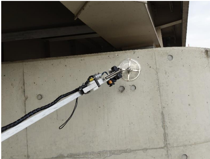
写真-3 損傷確認 (ひびわれ)
