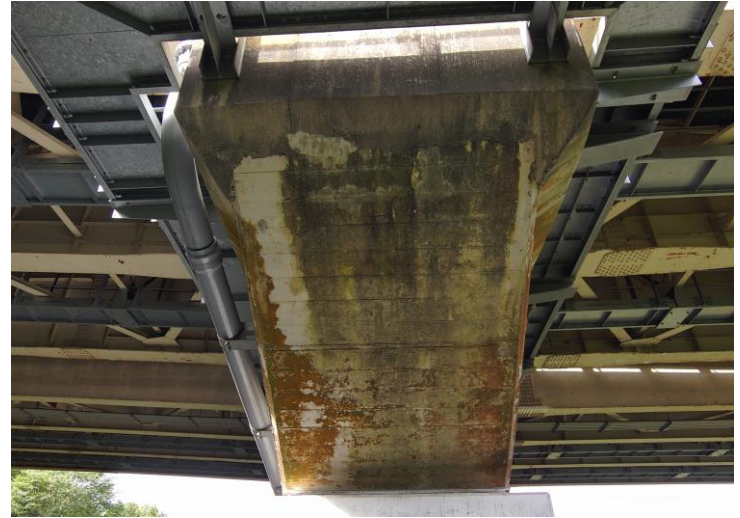
写真-2 梁(伝い水汚れ:e)
