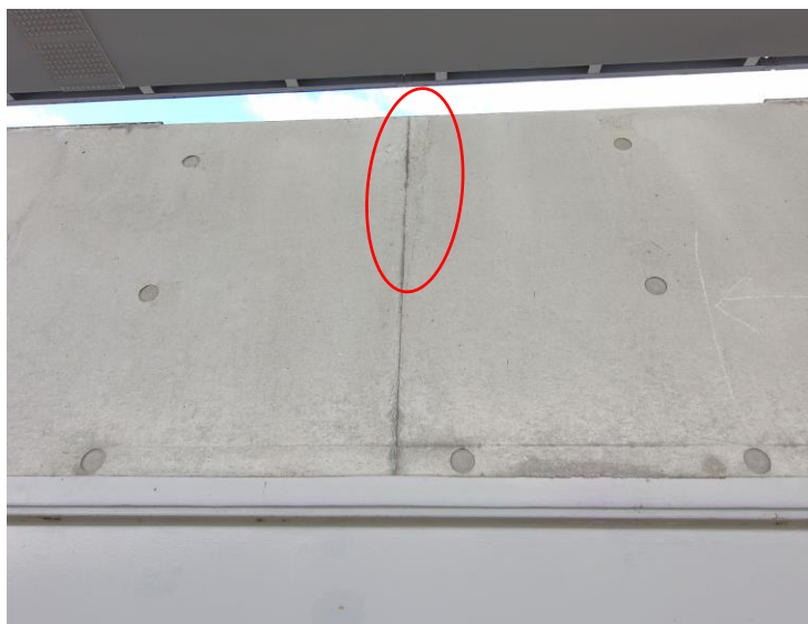
写真-3 防護柵(ひびわれ W=0.1mm:b)
