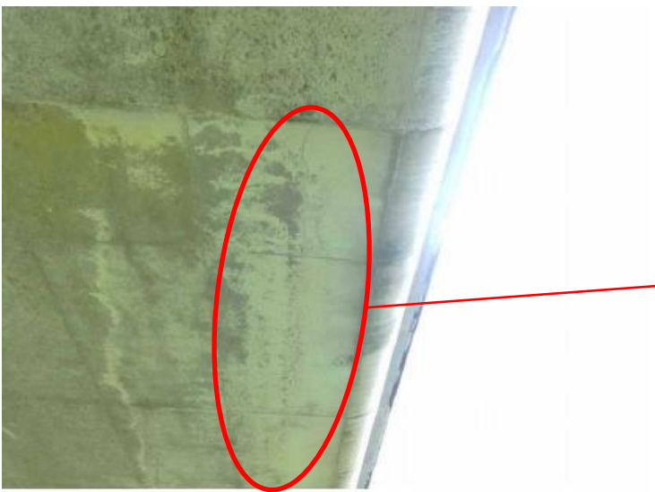
写真-3 主桁(ひびわれ W=0.1mm: 損傷程度c)
