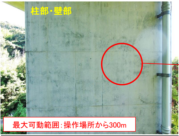
写真-3 橋脚(ひびわれ W=0.1mm: 損傷程度b)
