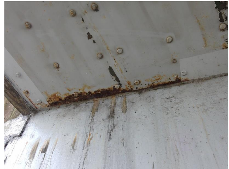
写真-2 損傷写真(腐食)
