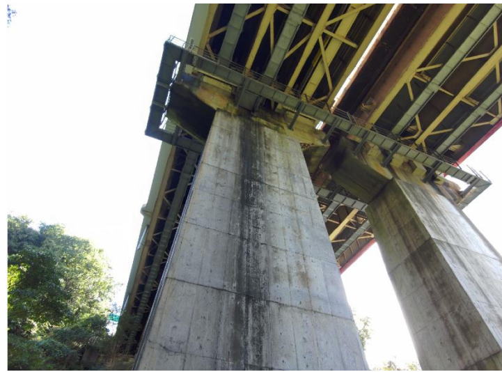
写真-2 柱(伝い水汚れ:e)
