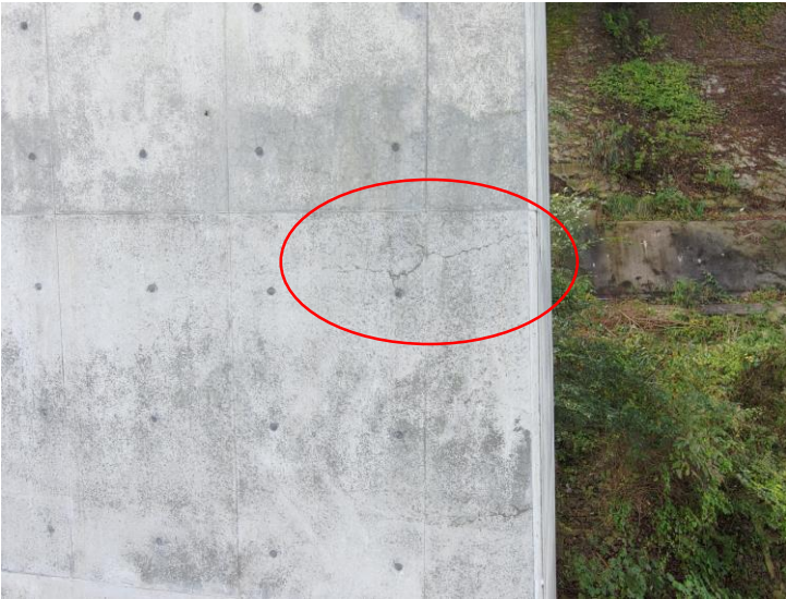
写真-3 柱(ひびわれ W=0.2mm:c)
