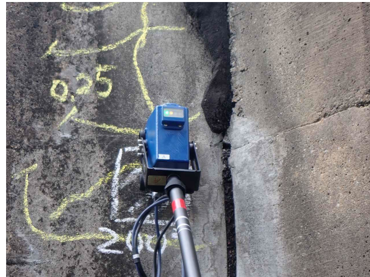
写真-2 損傷確認
