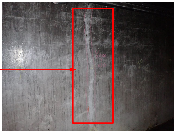
写真-4 損傷箇所
