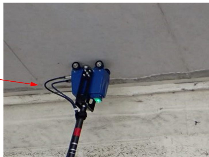
写真-4 健全[LED点灯]
