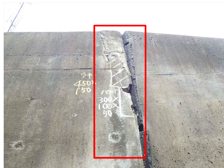
写真-4 損傷箇所
