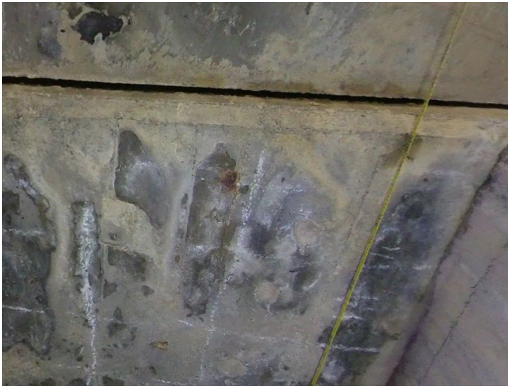
写真-3 主桁(剥離・鉄筋露出:d)
