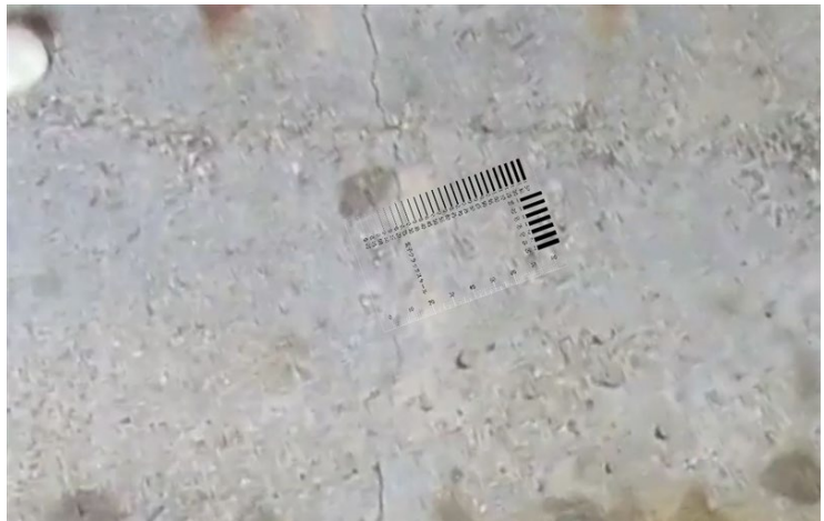
写真-4 縦壁(ひびわれ:d)
