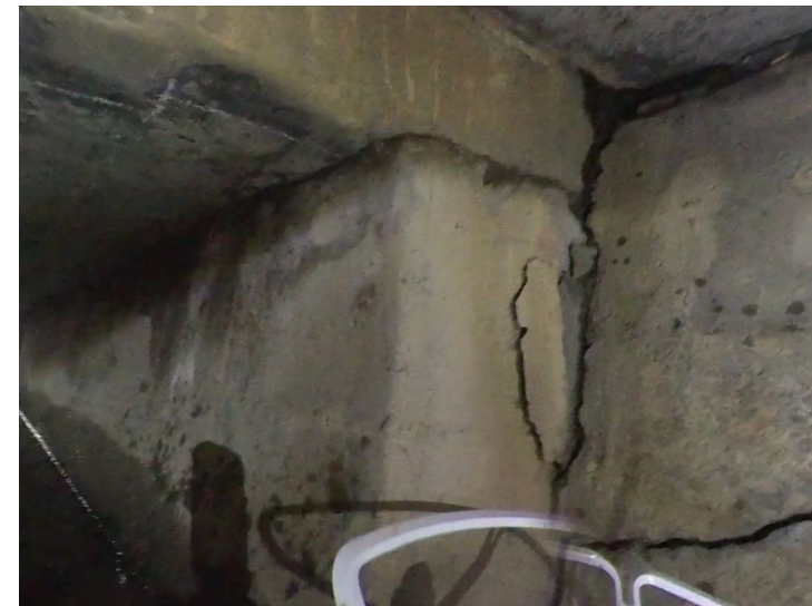
写真-4 縦壁(うき:e)
