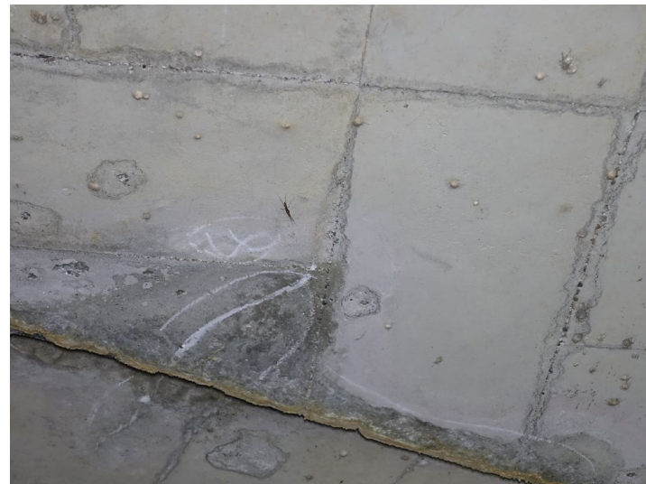
写真-2 頂版(漏水・滞水:e)
