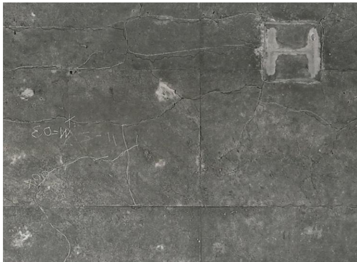
写真-3 画像展開図(ひび割れ)
