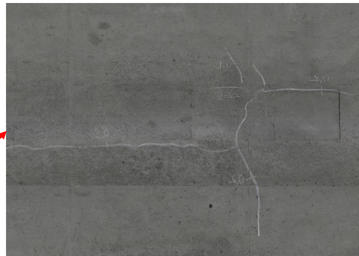
写真-2 画像展開図(ひび割れ)
