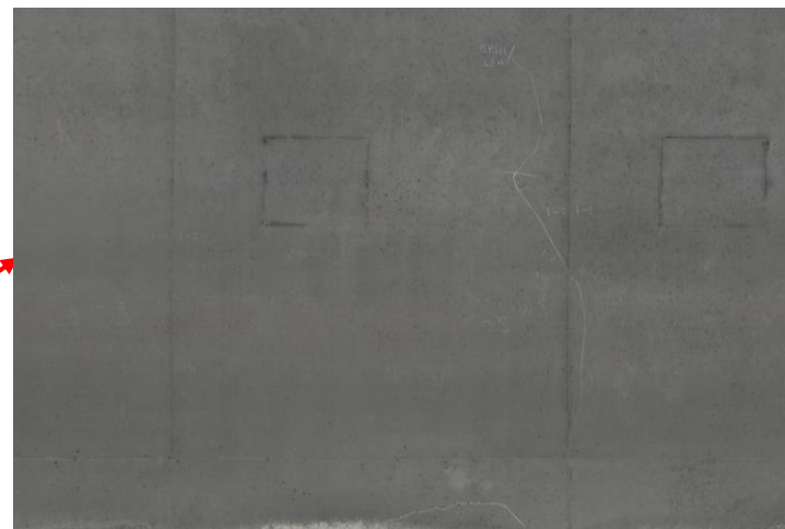
写真-2 画像展開図(ひび割れ)
