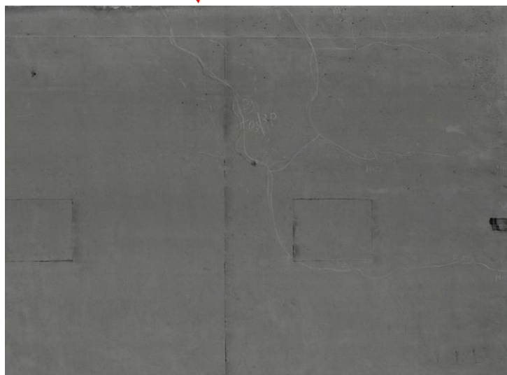
写真-3 画像展開図(ひび割れ)
