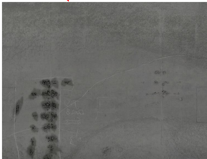
写真-3 画像展開図(ひび割れ, うき)
