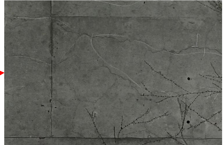
写真-2 画像展開図(ひび割れ)
