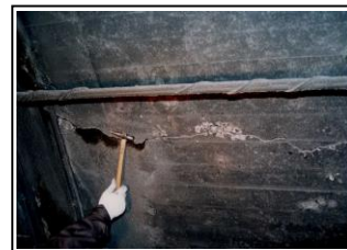
コンクリートの剥離
